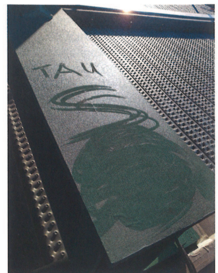
Betaute Oberfläche einer Umspannanlage
