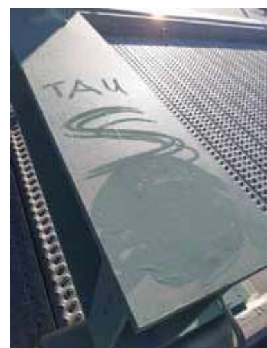
Betaute Oberfläche einer Umspannanlage © Geholit + Wiemer Lack- und Kunststoff-Chemie GmbH
