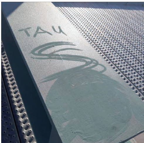
Betaute Oberfläche einer Umspannanlage
