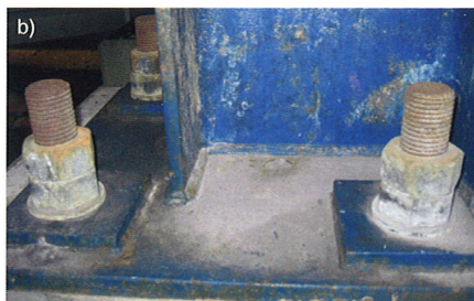
Bild 12. TREA in Breisgau, Zustand der beschichteten Stahlkonstruktion
