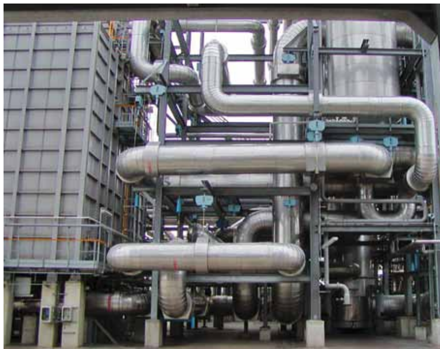
Bild 1: Rohrleitung in einer chemischen Anlage, gehalten durch LISEGA-Konstanthänger
